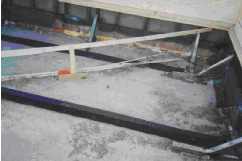
Foto 11 Soome kortermaja katusel on aurutõke vaid paneelide vahekohtades. Tuulutuskanalid on kaetud võrguga vältimaks kergkruusa sattumist kanalitesse ja võimaldades sellega konstruktsiooni tuulutuse kogu kihi paksuses.
